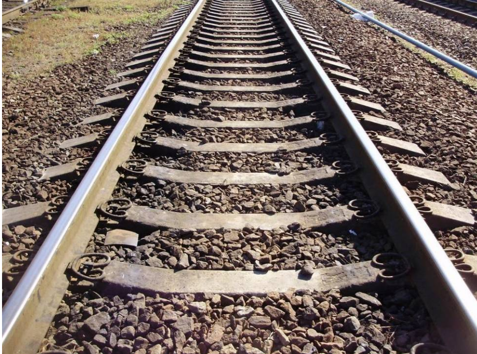
Рис. 5.2. Експлуатована дослідна ділянка залізничної колії з пружними рейковими скріпленнями УС-1 (PRS-1) через 15 років експлуатації
