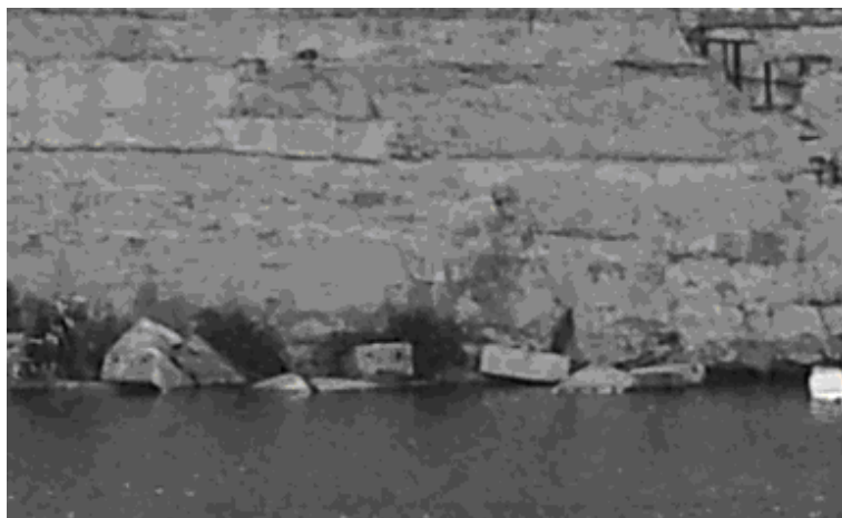
Рис. 3.15. Пошкодження облицювання набережної лівого берегу р. Харків: а – розташування місць пошкоджень; б, в – випадіння каменів облицювання
