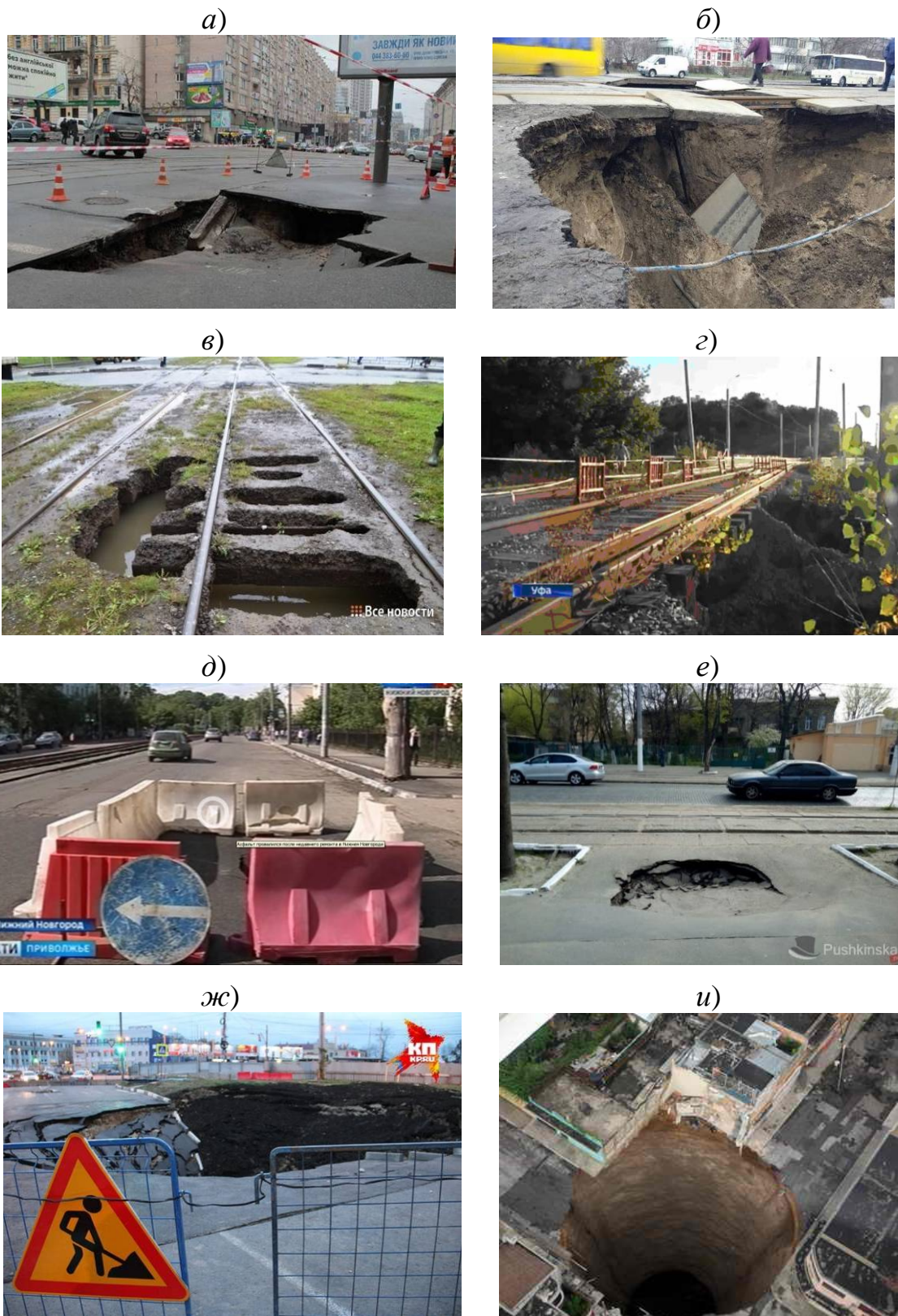
Рис. 1.5. Провали ґрунту під трамвайними коліями та біля них поруч (а – е) і автодорогами (ж, и): а – у м. Києві, [48]; б – у м. Києві [49]; в – у м. Нижній Тагіл [50]; г – у м. Уфа [51]; д – у м. Нижній Новгород [52]; е – у м. Одеса [53]; ж – у м. Нижній Новгород [54]; и – у с. Бутурліно близь м. Нижній Новгород [55]
