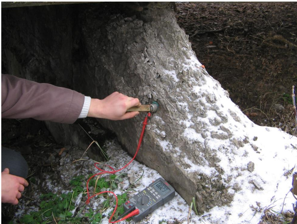
Рис. 1.12 Вимірювання електричних потенціалів на поверхні пошкоджених конструкцій високих пасажирських платформ: а – на плитах і верхній частині опор; б – у нижній частині опор
