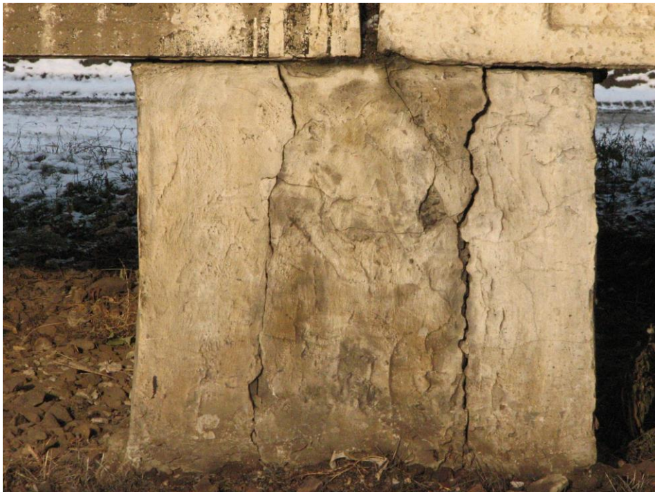
Рис. 1.11 Пошкодження раніше відремонтованих опор пасажирських платформ із блоків бетонних (з. п. Водяне): а – тріщини у штукатурногму покритті та його відшарування з боку колії; б – тріщини між опорою та підсиленням із оштукатуреної цегляної кладки
