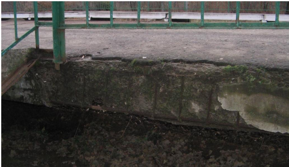
Рис. 1.6 Пошкодження конструкцій пасажирських платформ – відшарування та відколи захисного шару ребер плит покриття з оголенням арматури: a – з незначною корозією арматури (з. п. Високий Південної залізниці); б – з помітною корозією арматури (з. п. Покотилівка Південної залізниці)
