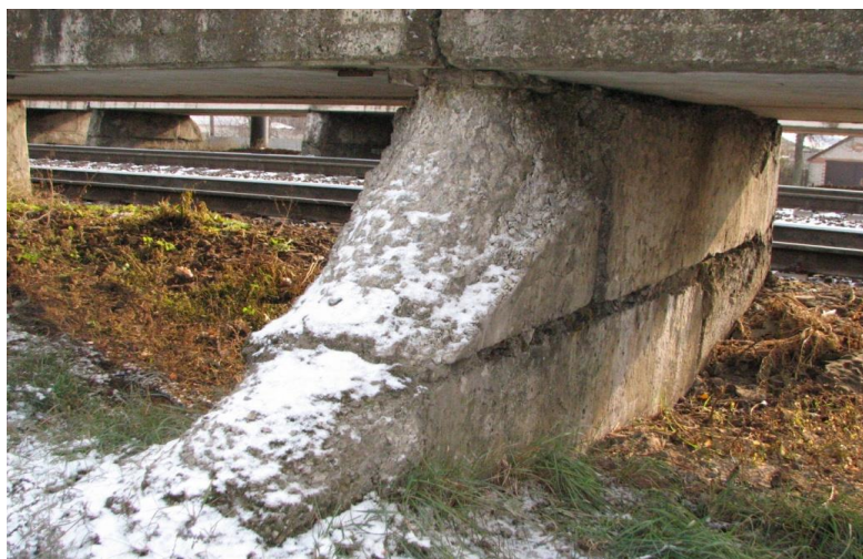
Рис. 1.9 Пошкодження опор пасажирських платформ із блоків бетонних: a – вилугування (з. п. Високий); б – руйнування бетону в зоні обпирання плит (з.п. Коротич); в – значне руйнування бетону в зоні обпирання плит з їх «зависанням» (з. п. Водяне)
