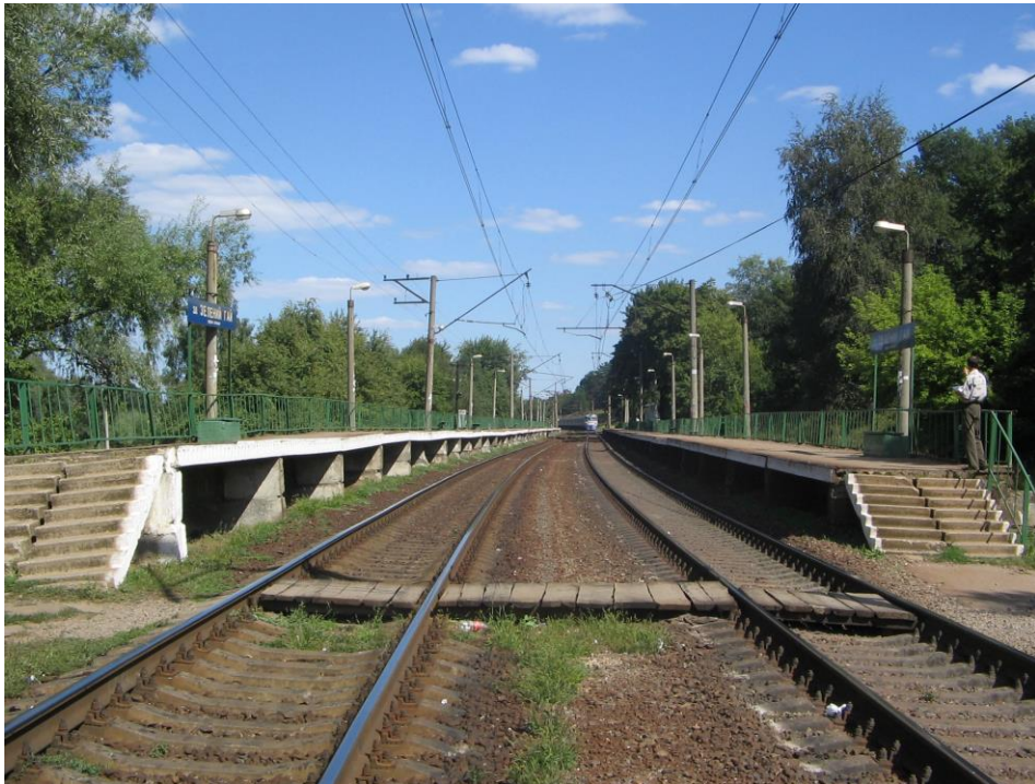
Рис. 1.10 Пошкодження високих пасажирських платформ з опорами із бетонних блоків у вигляді порушення проектного положення елементів внаслідок руйнування бетону опор (з. п. Зелений Гай Південної залізниці): a – осідання сходових маршів; б – перекіс платформи
