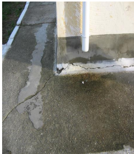
Рис. 1.2 Характерні пошкодження будівель вокзалів на електрифікованих постійним струмом ділянках залізниць (вокзал ст. Чистенька Придніпровської залізниці): а – загальний вигляд зі сторони залізничних колій; б – вертикальні
