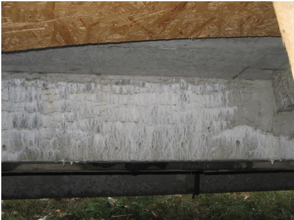
Рис. 1.5 Пошкодження конструкцій пасажирських платформ (з. п. Карачівка дільниці Харків – Мерефа Південної залізниці): a – пошкодження (втрата суцільності) асфальтобетонного покриття; б – вилуговування на ребрі плити платформи
