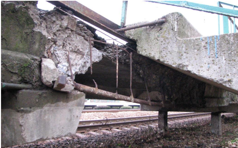
Рис. 1.7 Відшарування та відколи захисного шару ребер плит покриття пасажирських платформ зі значною корозією робочої арматури: а – з помітним зменшенням її перерізу, руйнуванням розподільчої арматури або втратою зв'язку робочої арматури з бетоном (з. п. Жовтневий Південної залізниці); б – з втратою зв'язку робочої арматури з бетоном та руйнуванням бетону стиснутої зони з помітним прогином плити (з. п. Покотилівка Південної залізниці)
