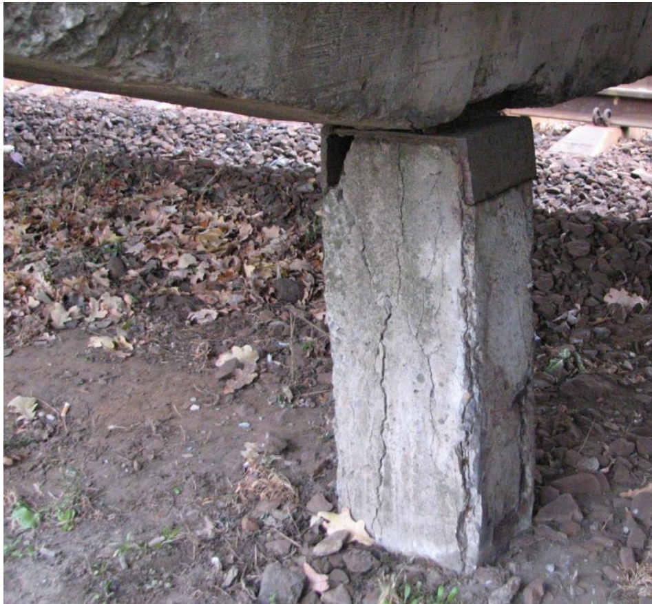
Рис. 1.8 Тріщини у залізобетонних конструкціях пасажирських платформ: а – у ригелях (з. п. Високий Південної залізниці); б – у стояках (з. п. Жовтневий Південної залізниці)
