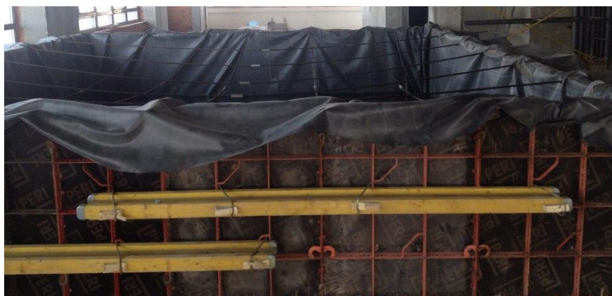
Рис. 4.9. Загальний вигляд резервуару для випробування перекриття
