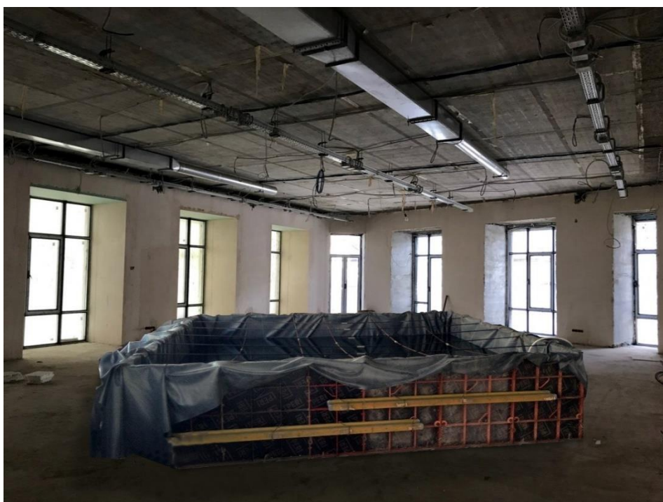
Рис. 4.12. Резервуар, встановлений на перекритті 3-го поверху
