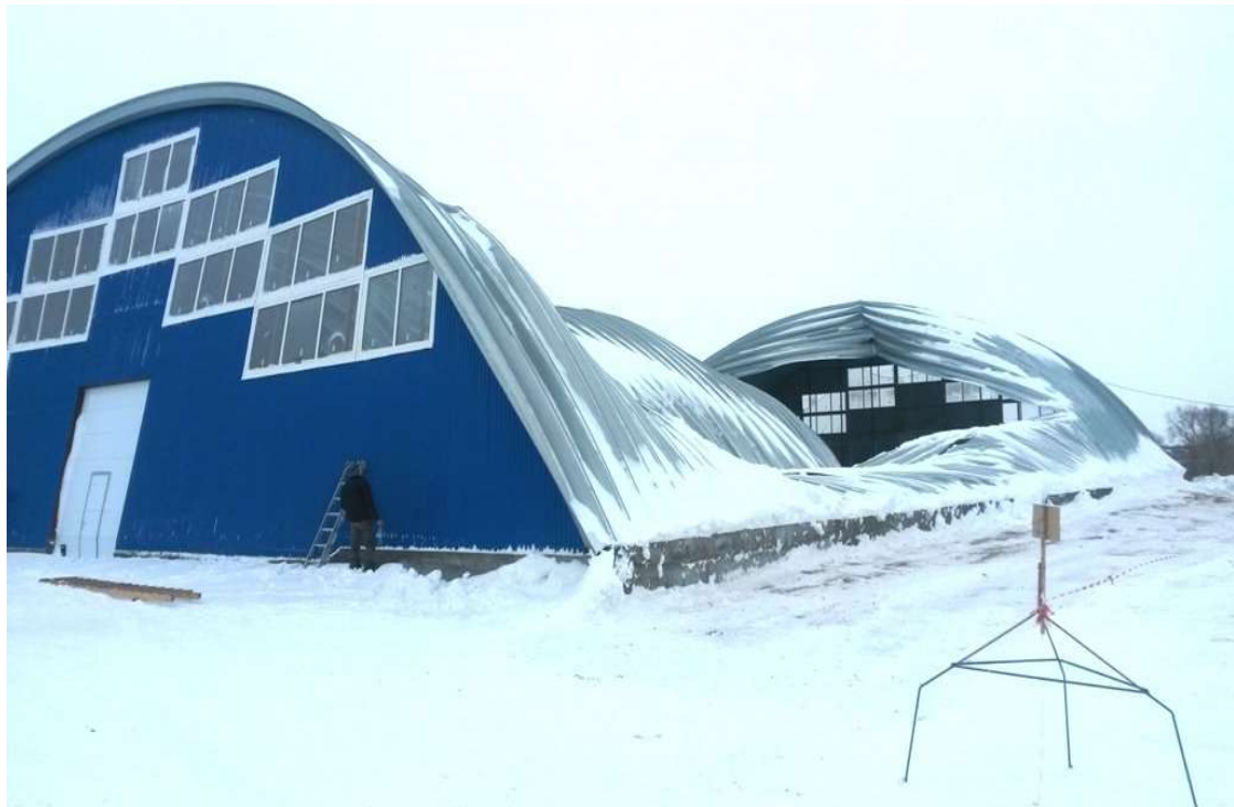
Рис. 1.6. Металева оболонка спеціального виду після обвалення.
