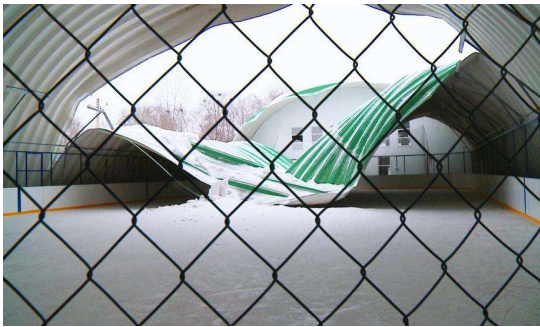
Рис. 1.7. Обвалення конструкцій льодової арени
