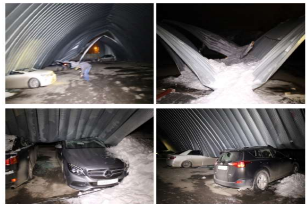
Рис. 1.10. Обвалення покриття автопаркінгу м. Іркутськ
