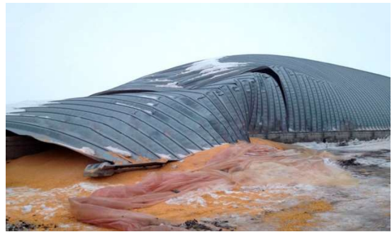
Рис. 1.8. Обвалення конструкцій зерносховища кукурудзи
