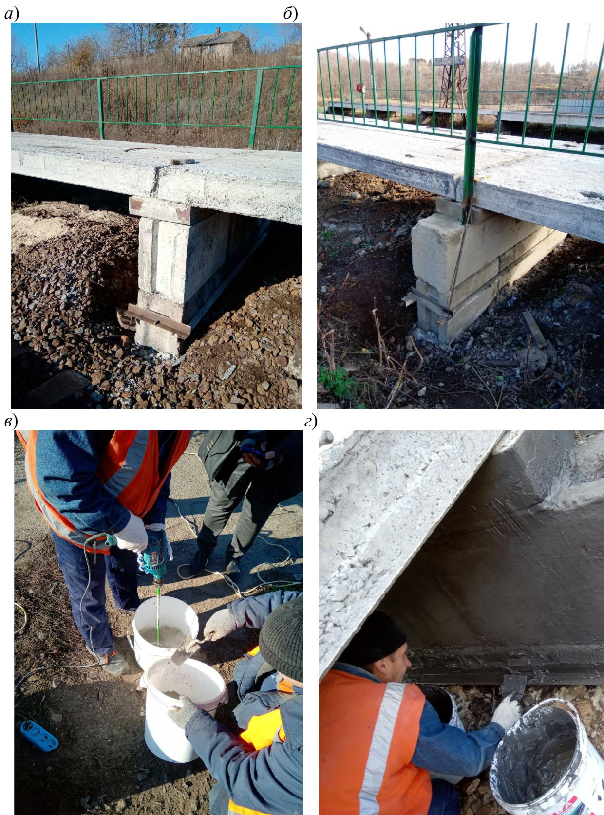
Рис. 5.5 Улаштування екранного захисту опор пасажирських платформ: а, б – монтаж заземлення – сполучної деталі екрану у вигляді сталевих поясу ( а ) і з'єднувального провідника із заземленим огородженням платформи ( б ); в – замішування композиції; г – ґрунтування поверхні опори і заповнення композицією зазору між сполучною деталлю й поверхнею опори
