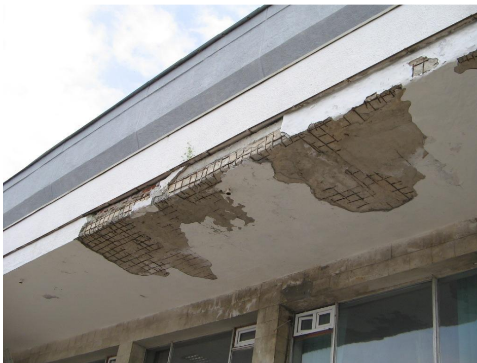
Рис. Б.4 Корозійні ушкодження залізобетонних конструкцій: a – прогонової споруди пішохідного мосту; б – плити балкону
