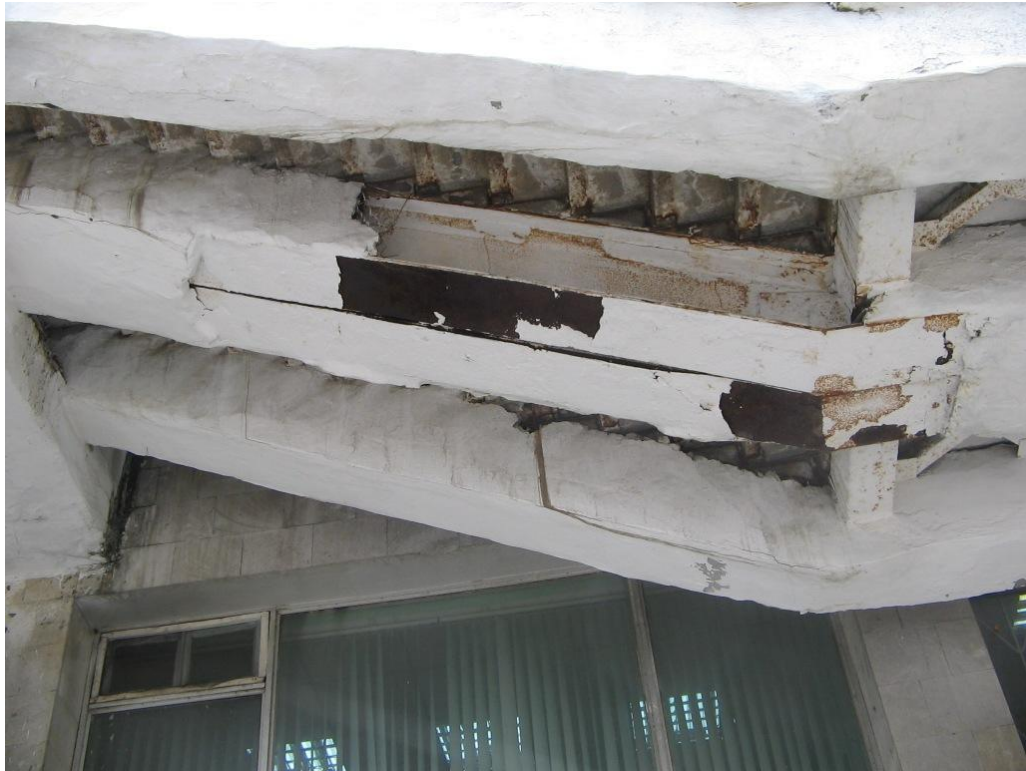
Рис. Б.7 Корозійні ушкодження сталевих оштукатурених косоурів сходів з балкону
