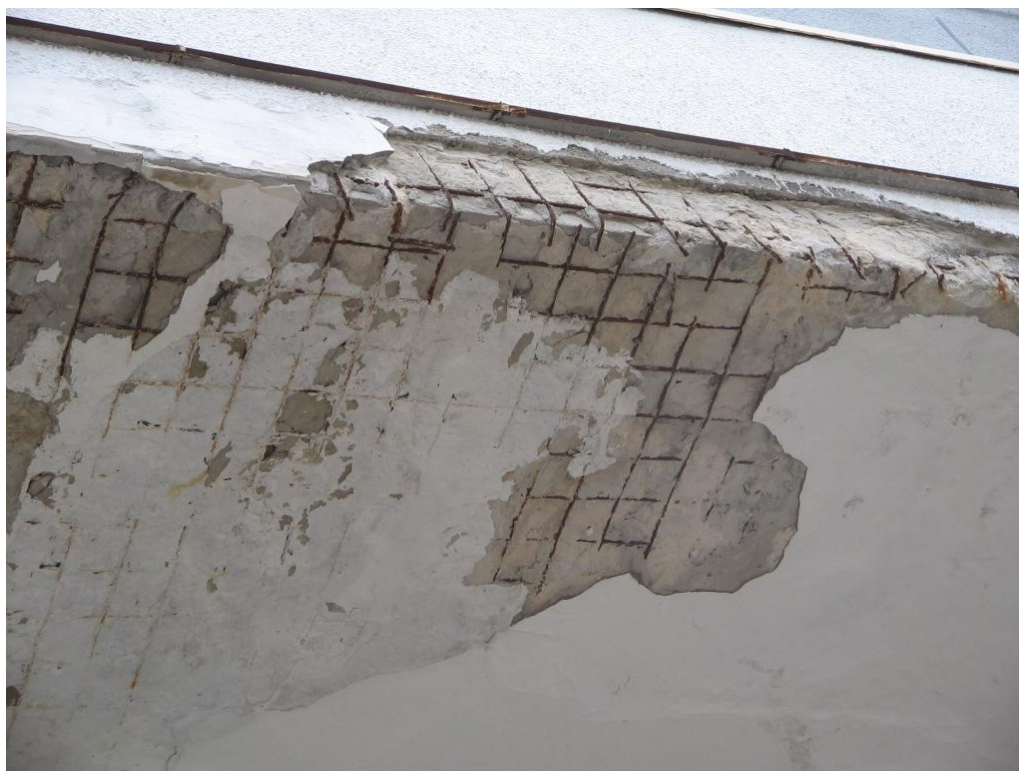
Рис. Б.6 Корозійні ушкодження нижньої грані та ребра залізобетонної плити балкону з відшаруванням ремонтної штукатурки
