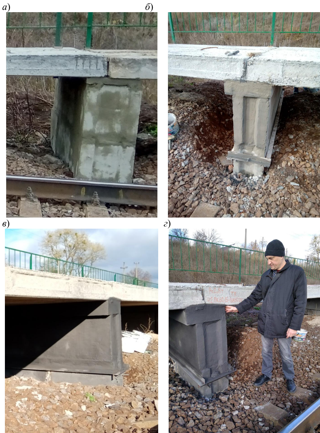
Рис. 5.7 Захисні екрани пасажирських платформ: а–в – із композиції на основі портландцементу без графітового наповнювача і заземлення ( а ), без графітового наповнювача з заземленням ( б ), з графітовим наповнювачем і заземленням ( в ); г – із силікатної композиції з графітовим наповнювачем і заземленням
