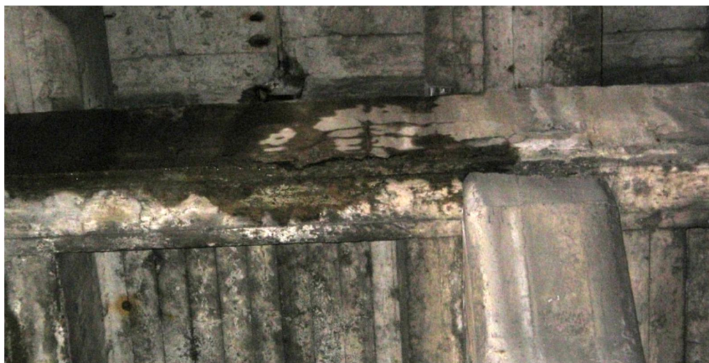
Рис.В.8 Пошкодження конструкцій автодорожнього шляхопроводу на 6 км ПК10 ділянки Харків – Люботин (ст. Нова Баварія): а – відшарування захисного шару і корозія арматури ригеля в зоні підвіски контактного проводу; б – відшарування захисного шару і корозія арматури прогонової споруди в зоні підвіски контактного проводу; в – інтенсивне вилугування бетону конструкцій шляхопроводу
