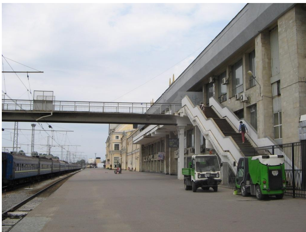
Рис. Б.1 Балкон 2/3-поверхового крила вокзалу Харків-пас.: а – загальний вигляд; б – сполучення балкону з пішохідним мостом та сходами на перон
