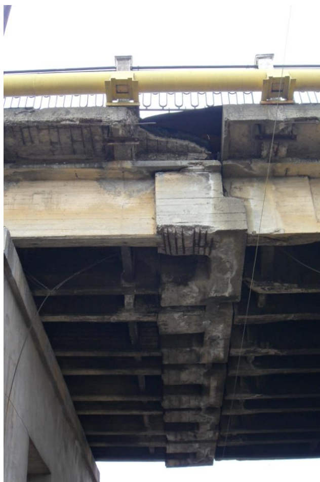
Рис. В.2 Пошкодження конструкцій автодорожного шляхопроводу на 775 км ПК7 ділянки Козача Лопань – Харків (з.п. Північний пост ст. Харків-сортувальний): а – тротуарних консолей; б – місць обпирання підвісних прогонів
