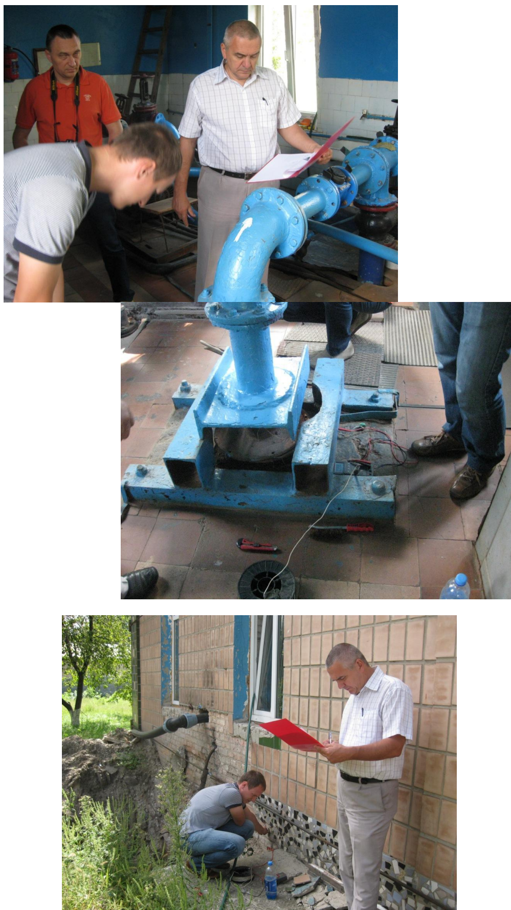
Рис. Г.2 Вимірювання електричних потенціалів на конструкціях будівлі водозабірної свердловини на ст. Основа та діля неї
