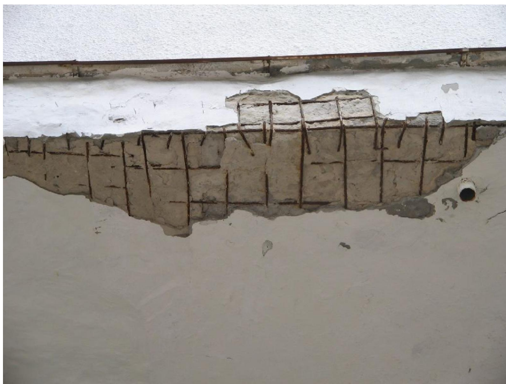
Рис. Б.5 Корозійні ушкодження нижньої грані ( a ) та ребра ( a, б ) залізобетонної плити балкону – руйнування захисного шару бетону і корозія арматури
