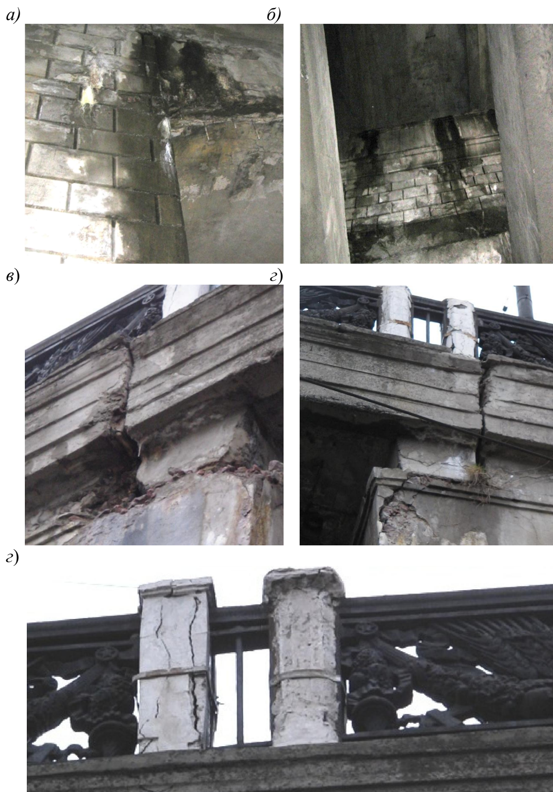
Рис.В.6 Пошкодження конструкцій автодорожнього шляхопроводу на 781 км ПК4 дільниці Козача Лопань – Харків (ім. М.Караєва, м. Харків): a – фільтрація води через тіло опори ( a ) та потік води по опорі ( b ) внаслідок порушення гідроізоляції; b – руйнування опорних ділянок: залізобетонних балок, опорних та підферменних блоків; e – пошкодження перильної огорожі шляхопроводу
