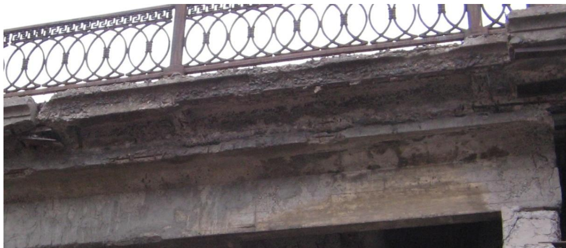
Рис.В.9 Пошкодження конструкцій автодорожнього шляхопроводу на 6 км ПК10 діляниці Харків – Люботин (ст. Нова Баварія, пр. Ново-Баварський, м. Харків): а, б – тріщини у верхній (а) та нижній (б) частині на стояках; в – руйнування бетону і корозія арматури тротуарних консолей
