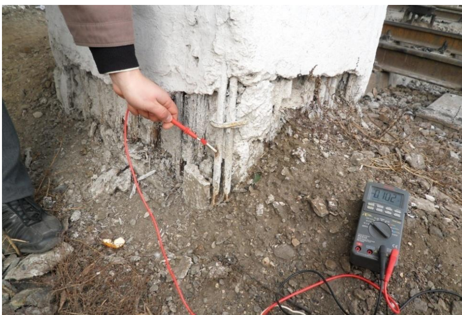
Рис. В.3 Пошкодження конструкцій автодорожного шляхопроводу на 775 км ПК7 ділянці Козача Лопань – Харків (з.п. Північний пост ст. Харків-сортувальний): а – тротуарних консолей; б – місце обпирання підвісних прогонів
