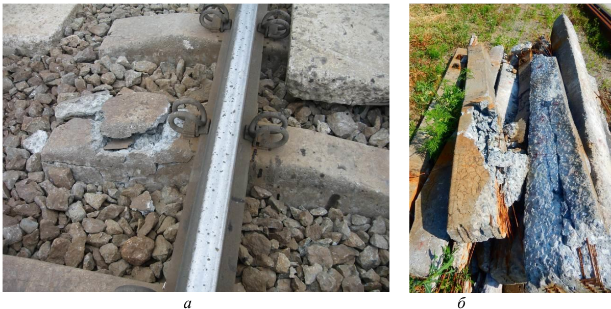
Рис. 1. Пошкодження залізобетонних шпал, що розвинулись із сітки тріщин: а – відколи бетону; б – повністю зруйновані шпали, вилучені з колії на ст. Бахмач Південно-Західної залізниці
