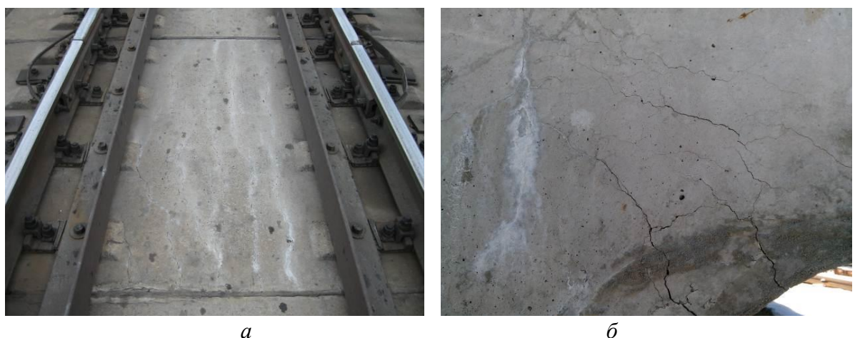
Рис. 2. Сітка тріщин у залізобетонних конструкціях: а – безбаластного мостового полотна; б – прогонової будови
