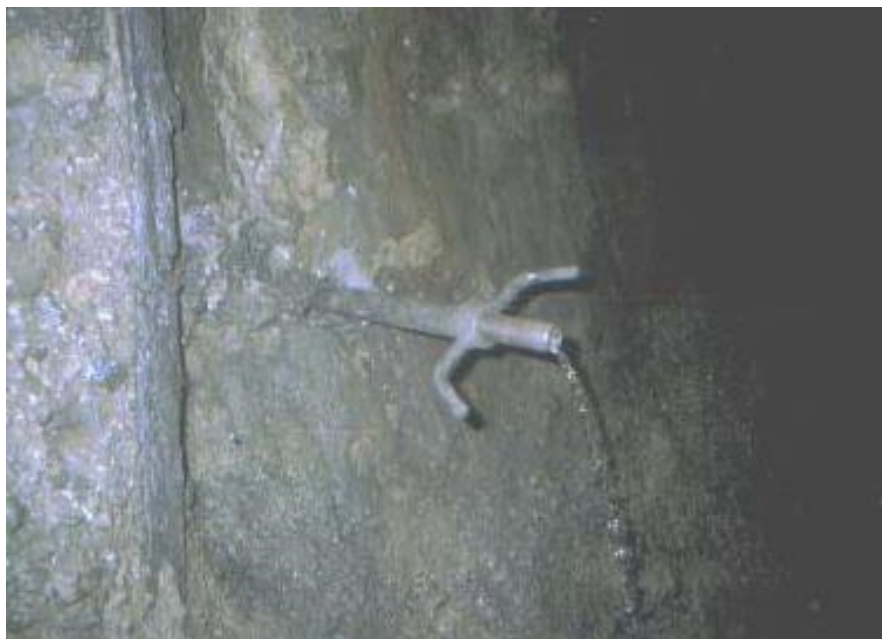
Рис. 1. Витікання води через ін'єктор, встановлений в шпарину, просвердлену в обробці тунелю до заобробкового простору
