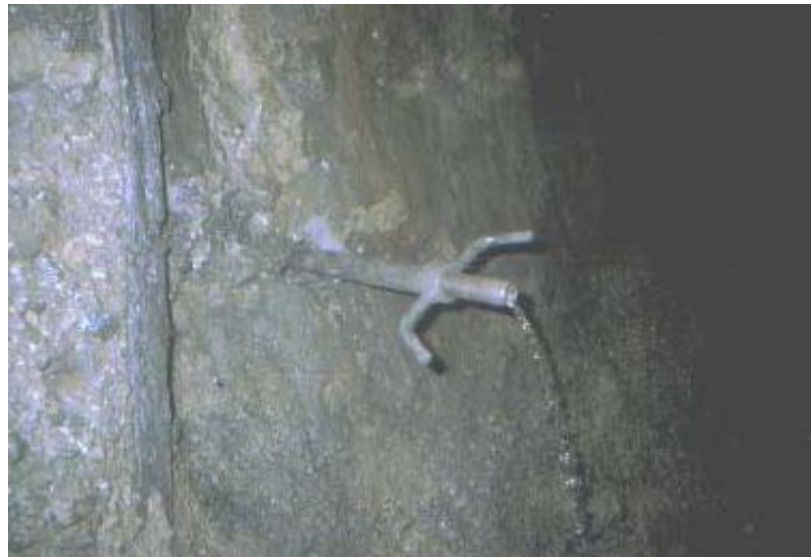
Рис. 1.3 Витікання води через ін'єктор, встановлений в шпарину, просвердлену в обробці тунелю до заобробкового простору
