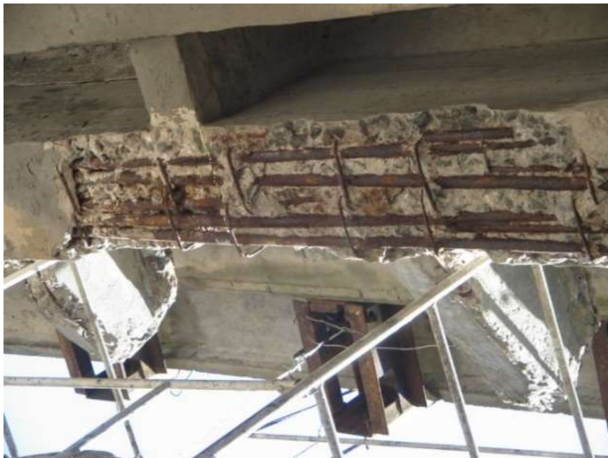
Рис. 6.1. Характерні пошкодження залізобетонних прогонових споруд
