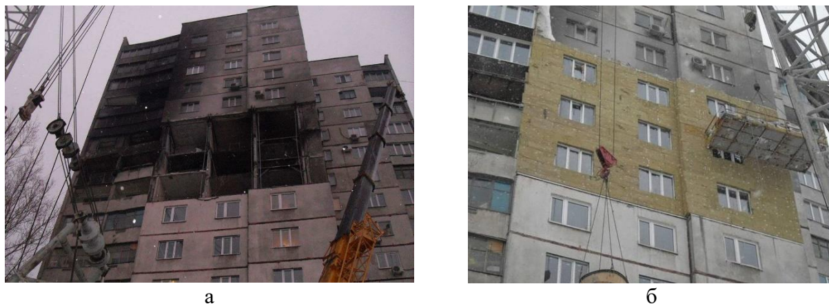
Рис. 13. Наслідки вибуху природного газу в шістнадцятиповерховому панельному будинку (а) і загальний вигляд відновленого фасаду (б)
