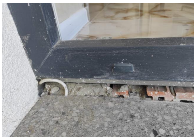
Рис. 1. Примикання балконної плити та балконного блока будівлі, зданої в експлуатацію
