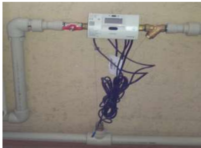
Рис. 4. Фрагмент установлення квартирної лічильника тепла
