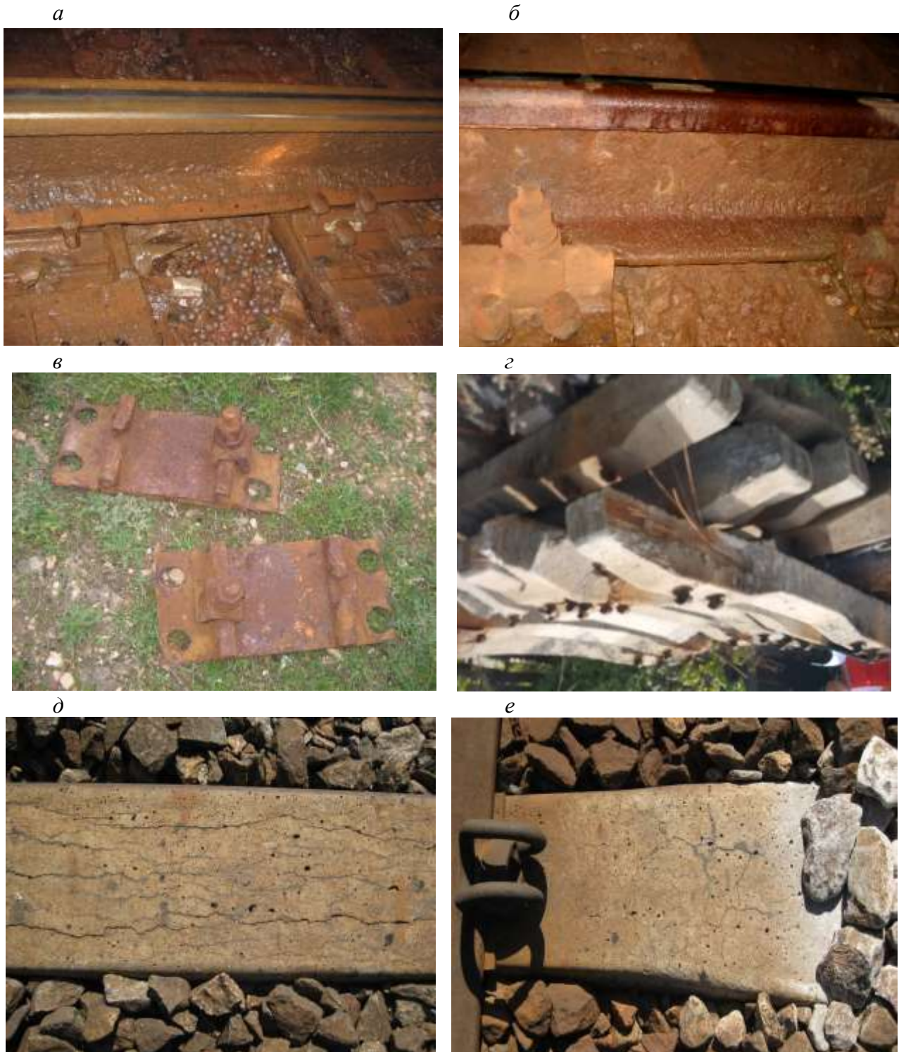
Рис. 4. Електрокорозійні пошкодження елементів верхньої будови колії в тунелях без зворотного склепіння (з природною основною площадкою): Бескидському (старому) Львівській залізниці (а), Сухарному Придніпровській залізниці (б, в) і на ділянці Основа – Букине Південної залізниці (г-е): а – шийки та підшви рейки, костильного скріплення Д0; б – шийки та підшви рейки, клемно-шурупного скріплення Д2; в – підкладок скріплення Д2; г – арматури залізобетонних шпал типу СБ3; г-е – бетону шпал типу СБ3
