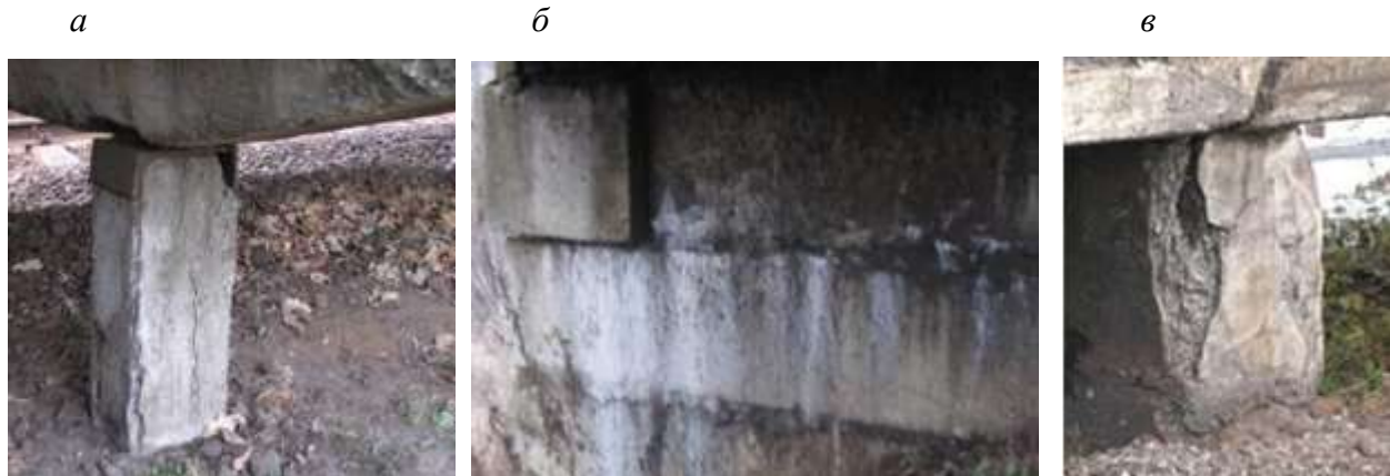
Рис. 5. Електрокорозійні пошкодження опор високих пасажирських платформ на ділянці Харків-Пас. – Мереха Південної залізниці: а – подовжні тріщини в залізобетонних стояках; б , в – патьоки вилуговування ( б ) і руйнування ребер ( в ) бетонних опор
