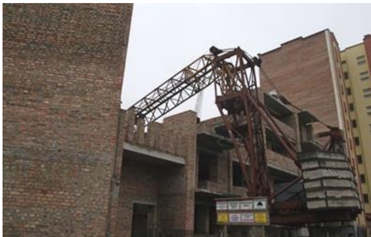
Рис. 1. Аварія баштового крана
