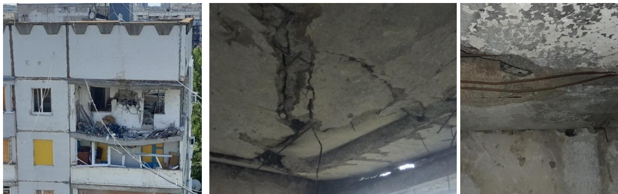
Рис. 7. Фотофіксація панелей перекриттів зі ступенем пошкодження 4
