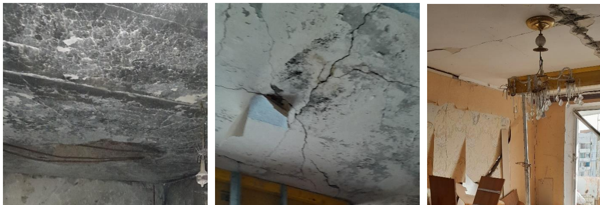
Рис. 6. Фотофіксація панелей перекриттів зі ступенем пошкодження 3
