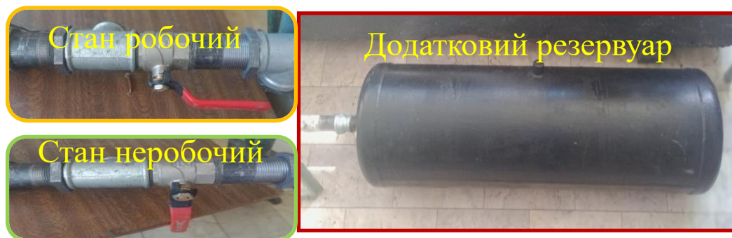
Рис. 3. Стани додаткового резервуара
