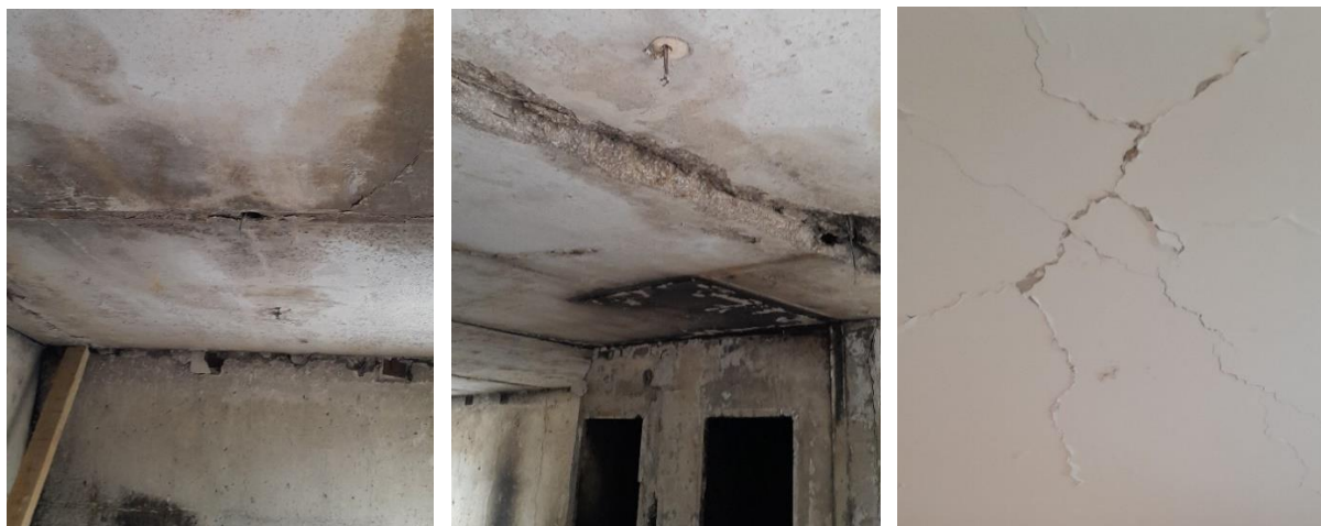
Рис. 5. Фотофіксація панелей перекриттів зі ступенем пошкодження 2
