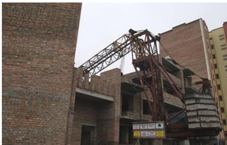
Рис. 1. Аварія баштового крана
