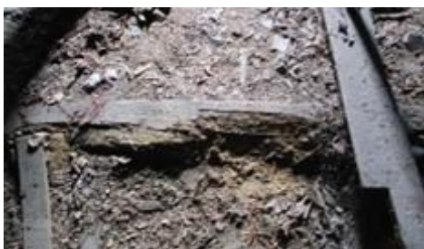
Рис. 1. Пошкодження дерев'яної балки горищного перекриття
