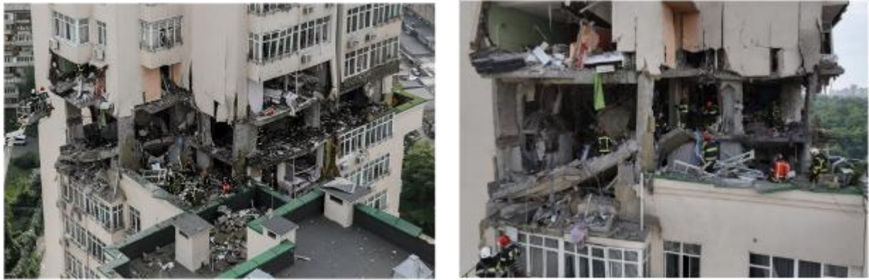
Рис. 1. Загальний вигляд пошкоджень та руйнувань конструкцій будівлі
