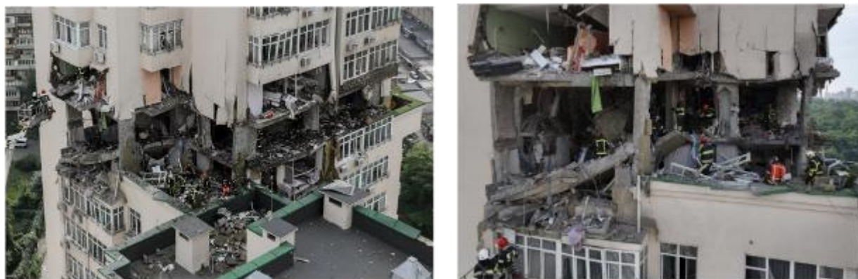
Рис. 1. Загальний вигляд пошкоджень та руйнувань конструкцій будівлі
