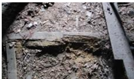
Рис. 1. Пошкодження дерев'яної балки горищного перекриття
