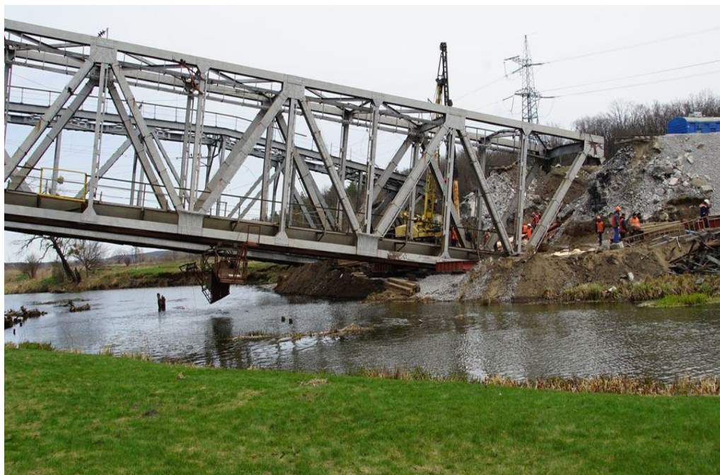
Рисунок В.2 – Зруйновані під час військових дій в Україні металеві залізничні мости:
