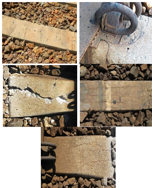
Рис. 1 Пошкодження (дефекти) шпал
