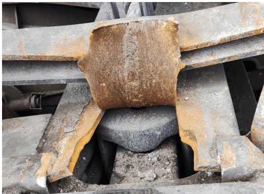
Рис.3. Пошкодження верхньої полки хребтової балки
