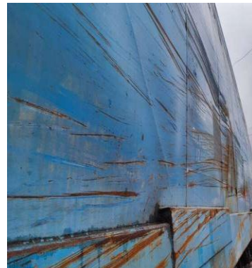
Рис.4. Пошкодження обшивки бокової
