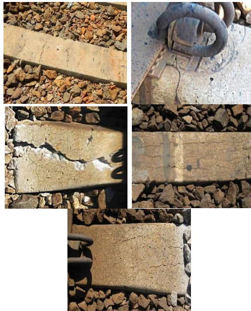
Рис. 1 Пошкодження (дефекти) шпал
