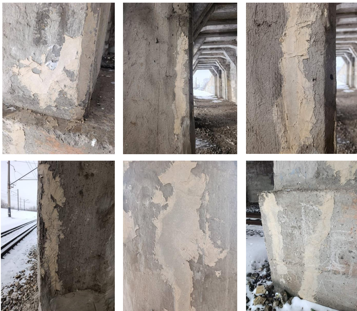
Рис. 5.6. Фото частин опори мосту після 1,5-річної експлуатації
