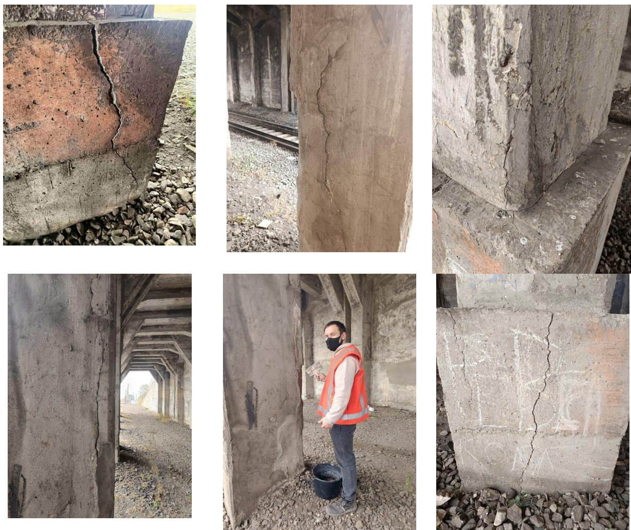
Рис. 5.1. Фото частин опори мосту до ремонту
